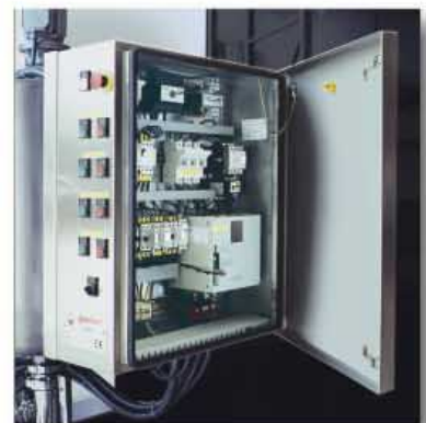
Quadro elettrico Electrical
